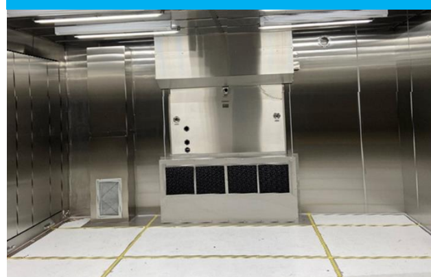
恒温恒湿室（室内）
