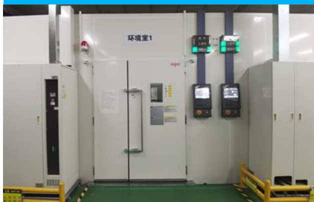
恒温恒湿室（2部屋）
