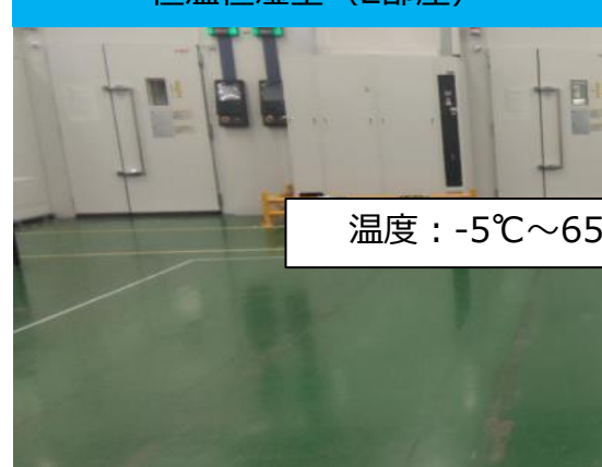
恒温恒湿室（2部屋）
